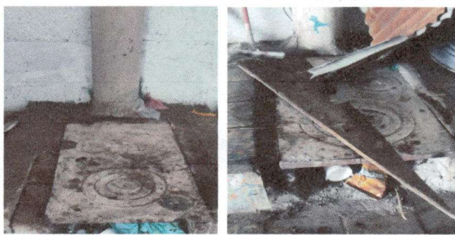
Foto 5: Mantenimiento a estufa rural
